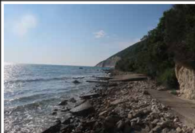
Oštećena betonska staza i ponte
