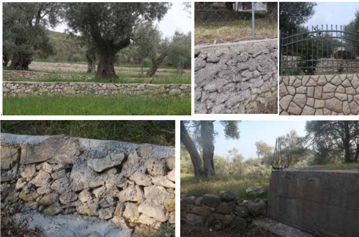
Lloje të ndryshme joadekuate ndërhyrjesh duke përdorur llaç çimentoje dhe beton
