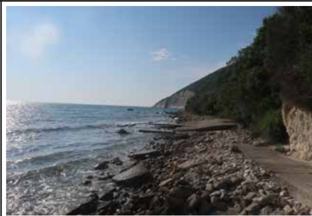
Shteg dëmtuar i betonit dhe pontja
