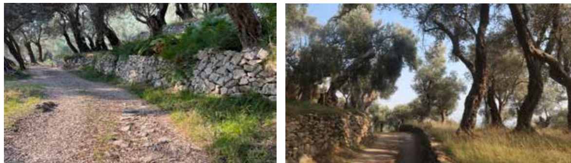
Mbetjet e kalldrëmeve të vjetra në rrugë; Pjesa e rrugës që kufizohet nga nën-muret e tarracave në njërin dhe anën tjetër
