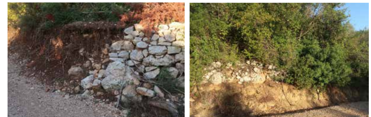
Obrušeni dio podzida i podzid koji je ostao iznad otkopanog segmenta puta, prošireni put prema Vakufskoj česmi, 2023.
