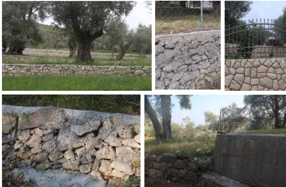
Različite neadekvatne vrste intervencija upotrebom cementnog maltera i betona
